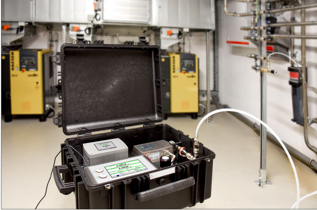
Uygulama: Kompresör odasında basınçlı hava kalitesi ölçümü - OIL CHECK 500 - DS500 - PC400
