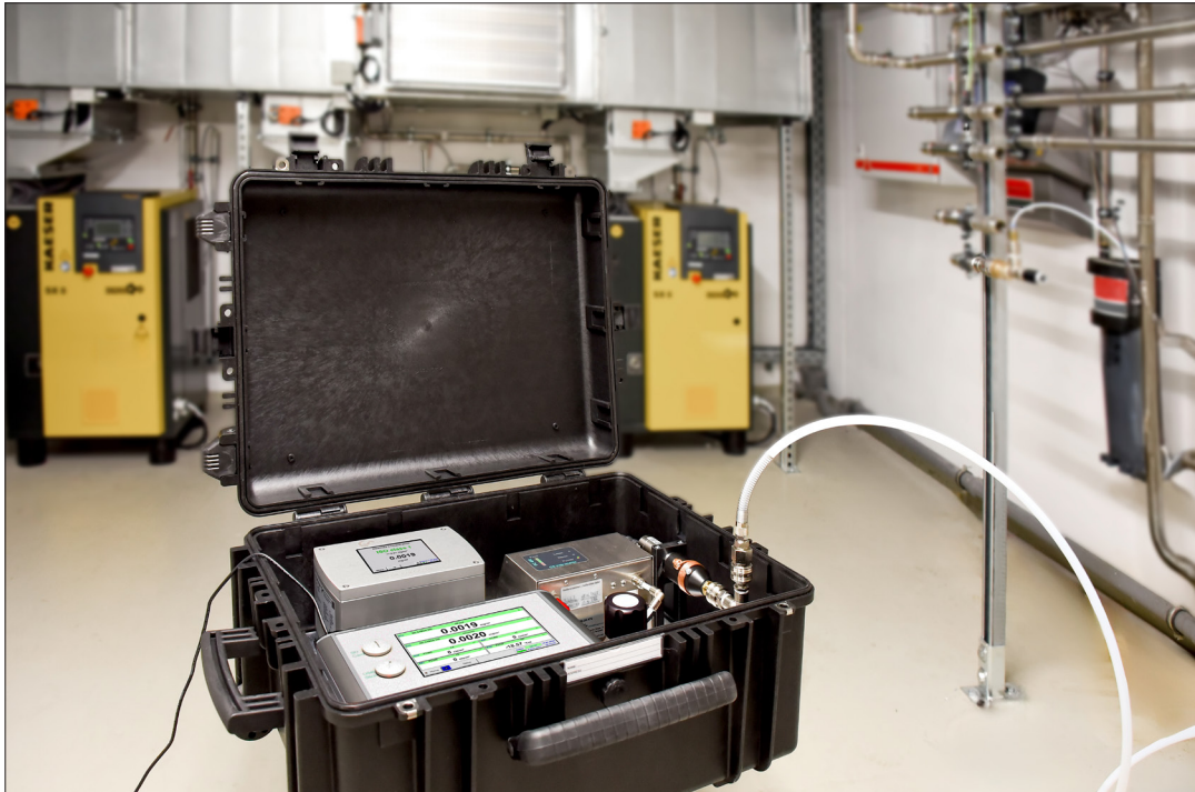
Applikation: Mätning i kompressorrummet - OLJEKONTROLL 500- DS 500 - PC 400
